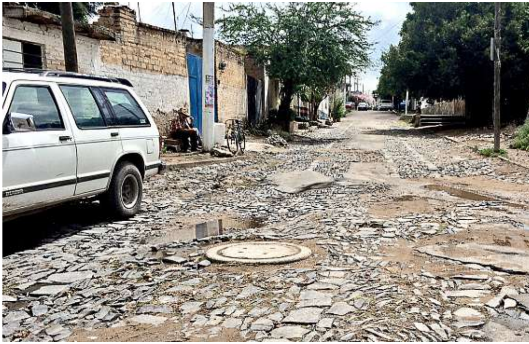
Las calles de Nextipac están deterioradas por la corriente de agua pluvial y el paso de camiones.
