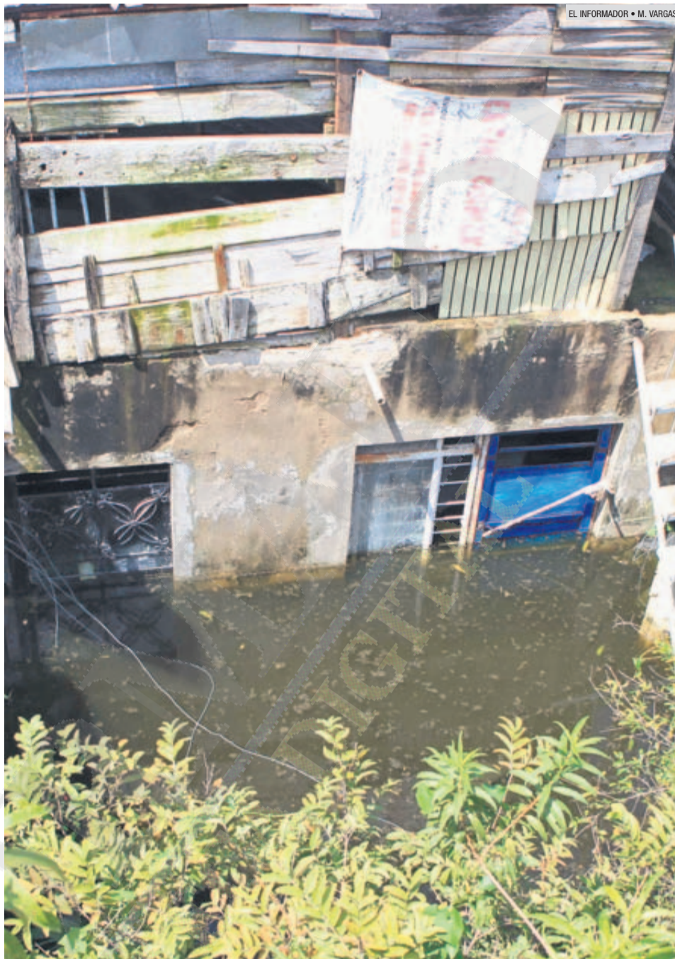
COLONIA EL HOYO. En esta vivienda aún permanece el nivel del agua a casi la mitad de la altura de los muros.
